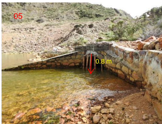
Aquí se observa el ingreso de agua al conducto.
