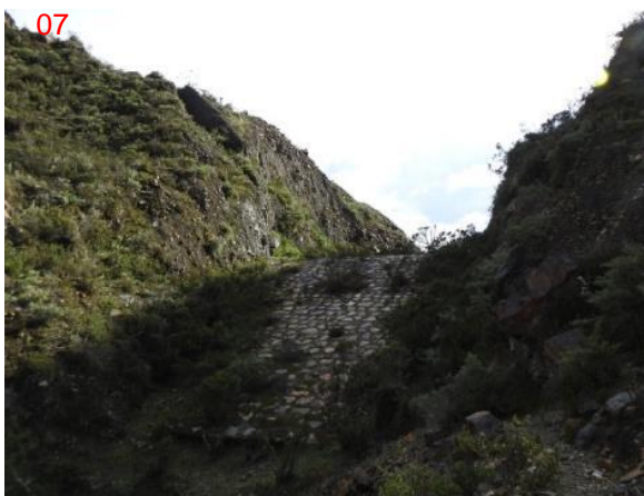
Aquí se puede apreciar el dique con presencia de vegetación
