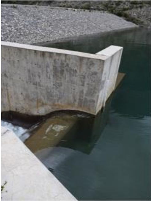
Fotografía N°6: Se observa el ducto de desfogue de agua de la laguna Rajucolta, el cual está en buenas condiciones.
