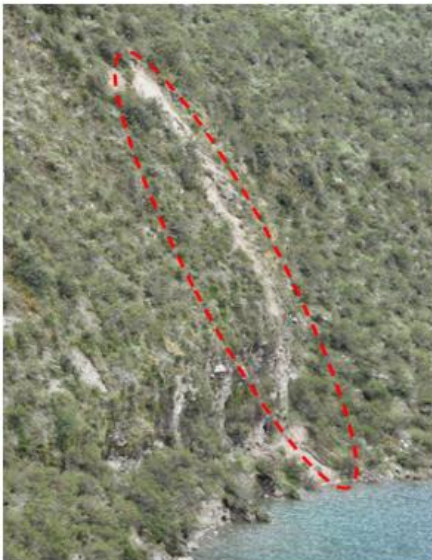
Fotografía N°4: Muestra deslizamientos de material morrénico del flanco derecho de la laguna Rajucolta.
