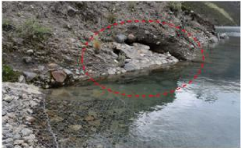
Fotografía N°7: Se observa parte de la obra de regulación, donde se ve el mal estado del muro de control de talud del flanco derecho y que podría afectar a la estructura.
