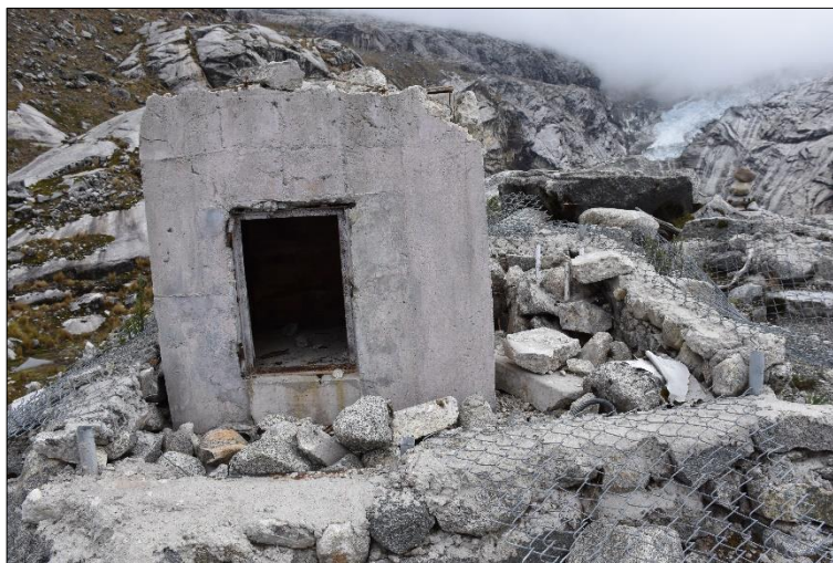
Fotografía N° 8: Estación de monitoreo del SAT destruido, ubicado sobre el dique de la laguna 513.
