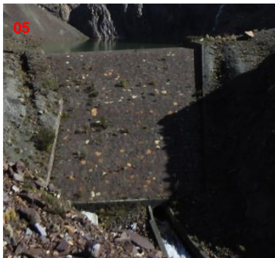
Esta imagen muestra la parte exterior del dique de seguridad y ducto de descarga
